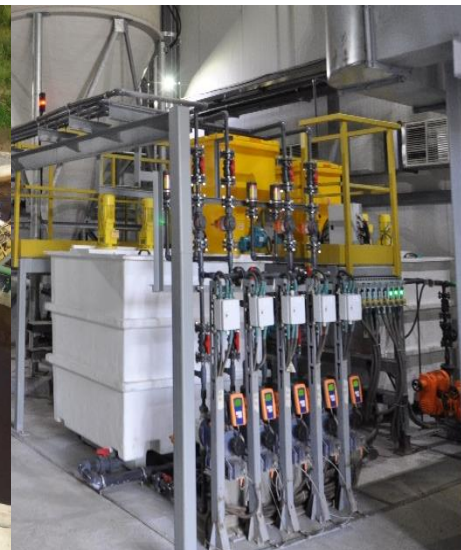
Сток 10. Система автоматического контроля сбросов
