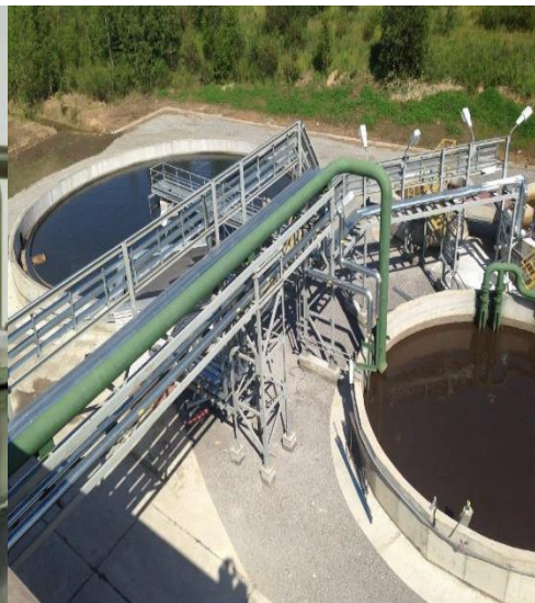
Реконструкция насосной станции № 5 с прокладкой трубопроводов для подачи технической воды до ж/д
